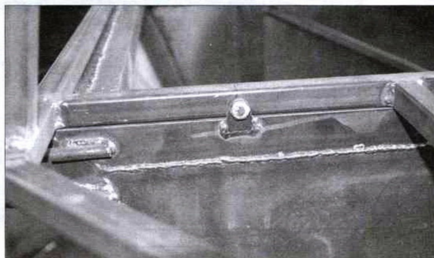
Листы кузова-лодки герметично приварены к каркасу внахлест, но не перекрывают его полностью. Верхняя рамка крепится на болтах
