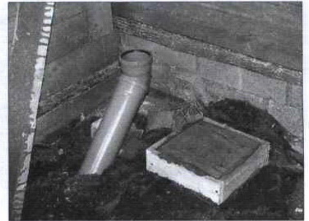
Трубы слива из унитаза. Рядом бетонный столбик для внутренней перекладины пола санузла
