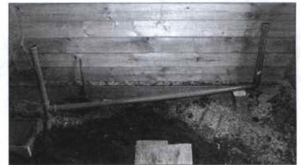
Трубы слива из душевой кабины и раковины
