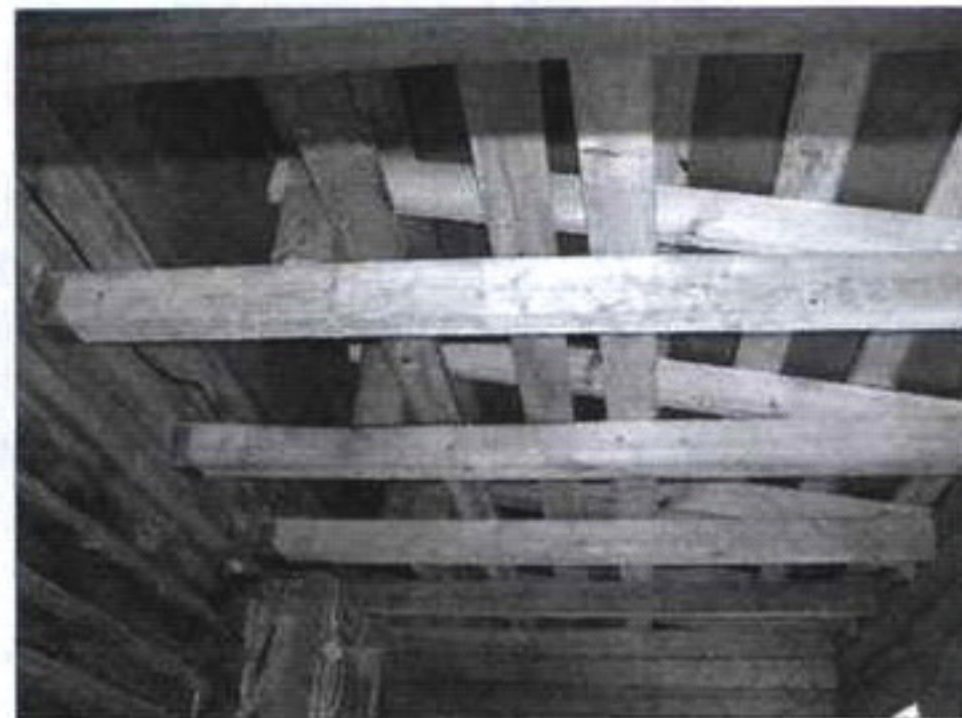
Фрагменты каркаса крыши. Стрелкой показана вертикальная стойка сечением 150x100 мм для крепления стропил
