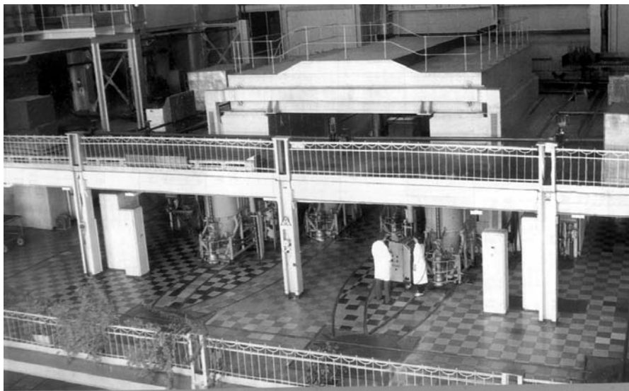
Фрагмент установки СУ-20
