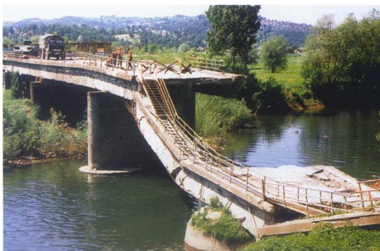
Рис. 4. Разрушенный мост через р. Усора в Югославии
