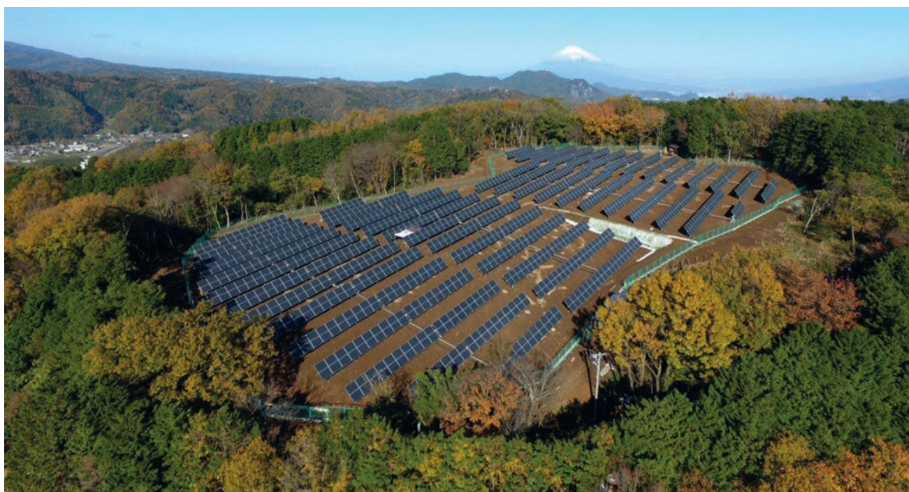
Солнечная электростанция мощностью 0,603 МВт, вдохновленная проектом «Реальность климата» (Япония)
