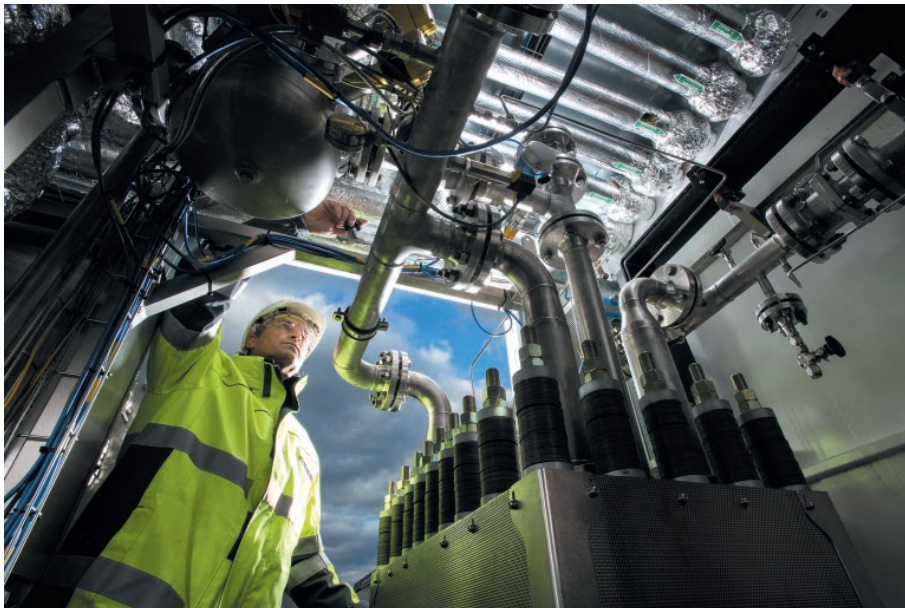
Инженеры в Гамбурге проверяют трубы, по которым транспортируется водород, полученный с помощью энергии от возобновляемых источников
