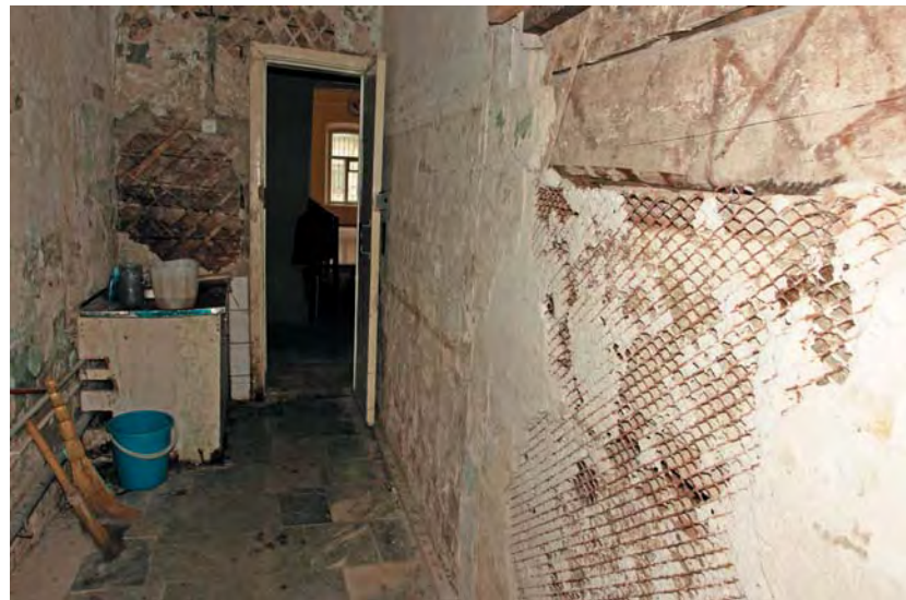
Разруха буквально сочится из стен
