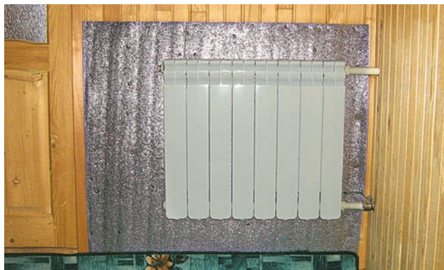
Чтобы уменьшить потери тепла, у радиатора на наружной стене на зиму ставлю экран из фольгированного полистирола
