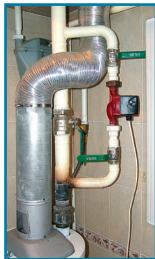
На отводе от напорной трубы дополнительно установлен насос принудительной подачи теплоносителя
