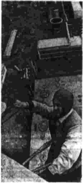
Самостоятельно трудятся болгарские монтажники на строительстве химического комплекса в Девенской долине. В с. и м. г. верхолаз Георгий Тодоров на сооружаемой трубе высотой 110 метров. Фото В. Егорова. (фотокорреспондент ТАСС).
