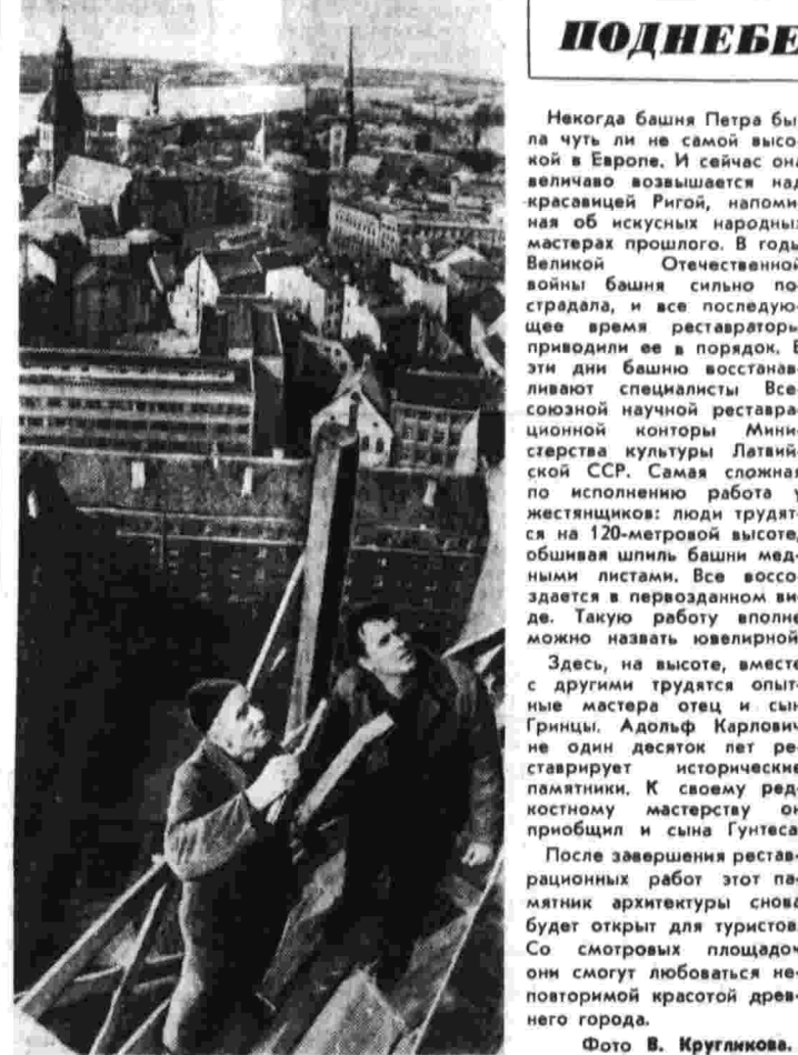
Некогда башня Петра была чуть ли не самой высокой в Европе. И сейчас она величаво возвышается над Красавицей Ригой, напоминая об искусных народных мастерах прошлого. В годы Великой Отечественной войны башню сильно повредила, и все последующие годы реставраторы приводили ее в порядок. В эти дни башню восстанавливают специалисты Всесоюзной научной реставрационной конторы Министрства культуры Латвийской ССР. Самая сложная по исполнению работа у мастеров: люди трудятся на 120-метровой высоте, обшивая шпиль башни медными листами. Все воссоздается в первоначальном виде. Такую работу вполне можно назвать ювелирной.
