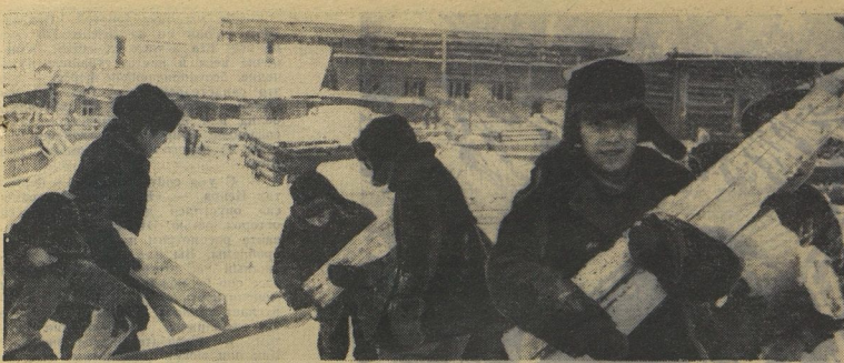
В посёлке Ансарка Тюменской области сооружают новую больницу. После уроков на помощь строителям приходят ученики Ансарковской школы-интерната.
