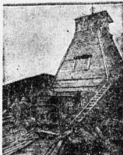
Свиристрой строится. Шахта для исследования грунта под плотником и зданием силовой станции.
