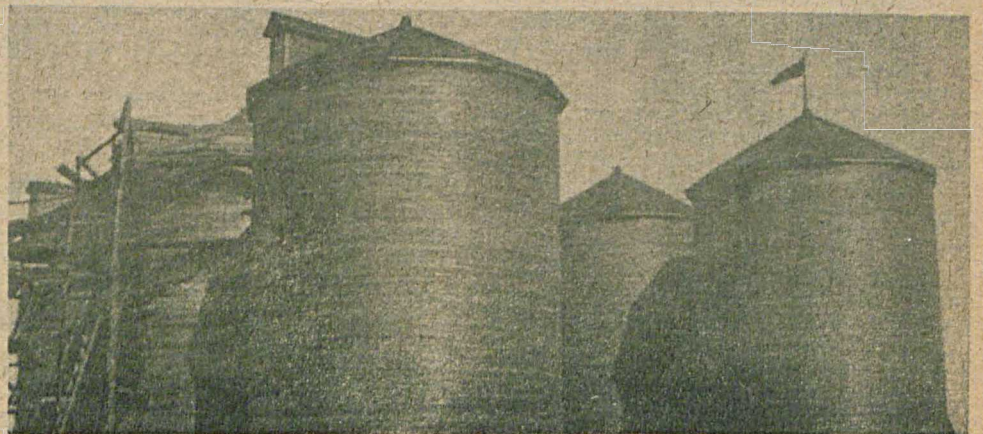
В ответ на обращение ЦК ВКП(б) об организации мясо-товарных хозяйств, Молочный и хозяйственный институт реорганизуем опытно-учебный совхоз «Молочное» (Вологодский район) На снимке: постройка силосной батареи в учебно-показательном совхозе «Молочное»
