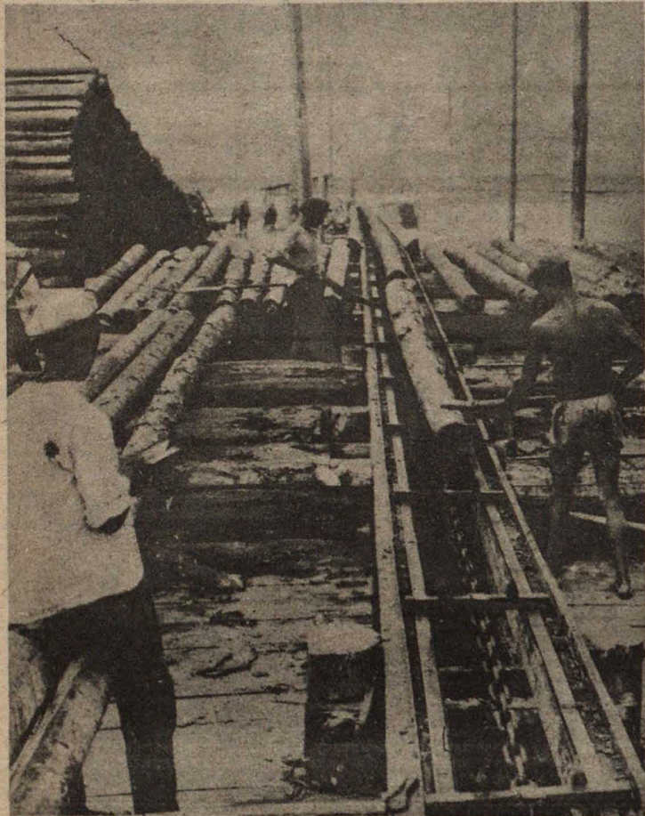
Механизация работ на лесопильных заводах. Конвейер, установленный на Астраханском лесопильном заводе. Бревна непосредственно с плотов передаются на завод под распилку
