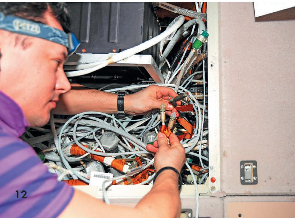
▼ Роман разбирается в хитросплетениях проводов и кабелей за панелями Служебного модуля
