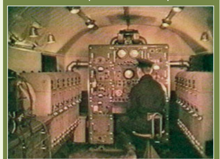
Пульт и фотоблоки станции «Трал»
