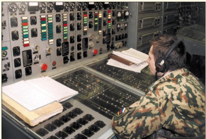
Пульт управления заправкой РН «Космос-3М» компонентами топлива
