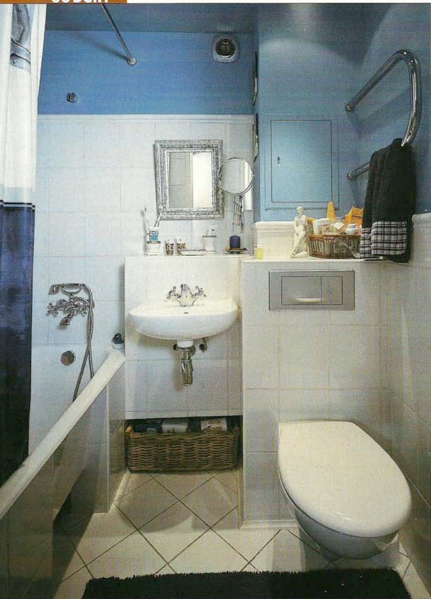
☛ Ванная. Плоскость, на которой нашлось место туалетным принадлежностям, образована двумя коробами, внутри которых скрыты трубы умывальника и система крепления унитаза
